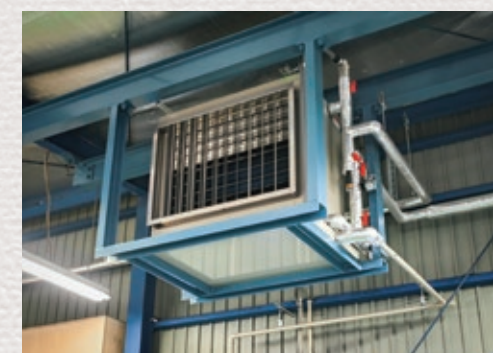
夏場の工場内の猛暑を緩和するため、環境に優しい井戸水クーラーを設置しました。
