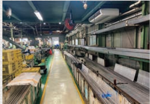
エアコンが設置されて作業環境が飛躍的に改善されました。
