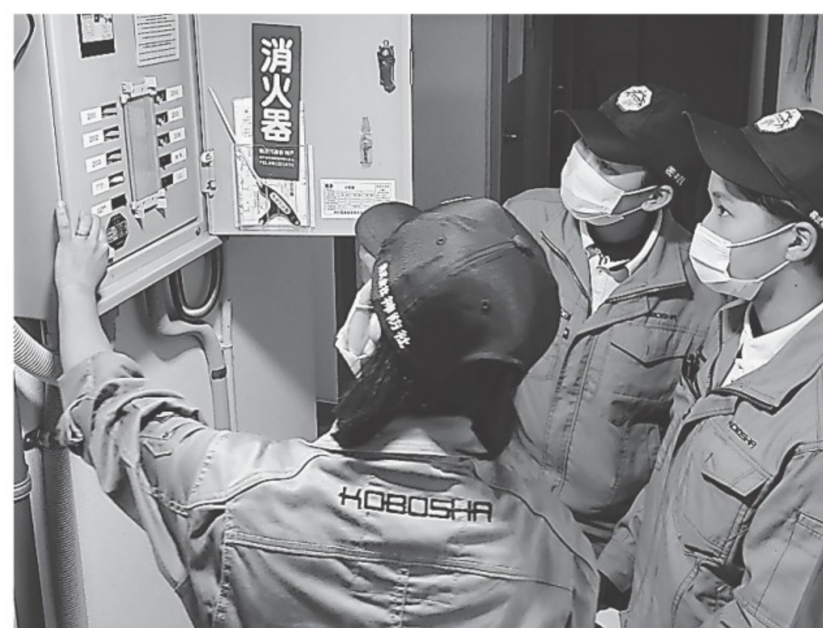
消防設備の点検を行う女性3人のメンテナンスチーム。女性専用サイト「KOBO GIRL」も開設
